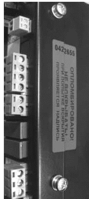
Рис.4. Пломбировка корпуса блока управления
